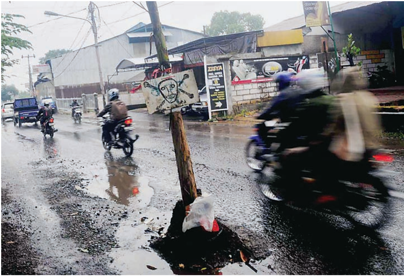
JALAN RUSAK: Pohon pisang ditanam di Jalan Pajajaran, Pamulang, Tangerang Selatan, kemarin. Warga setempat menanam pohon pisang di jalan yang rusak itu sebagai bentuk protes dan sekaligus petunjuk bagi pengguna jalan agar tidak celaka.
