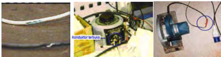
a b c Gambar 4.33 Contoh-contoh penyebab bahaya listrik (a) Kabel terkelupas (b) Konduktor yang terbuka (c) isolasi kabel yang sudah pecah
