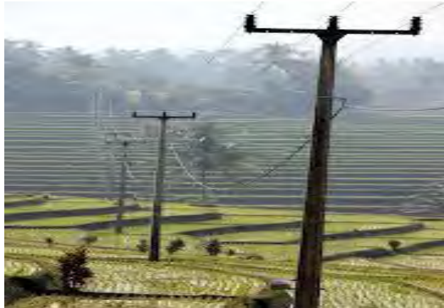
Gambar 4.26 Jaringan tegangan rendah
