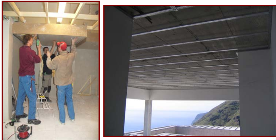
Gambar XII-11, Rangka Plafon dari Kayu dan Besi Hollow
