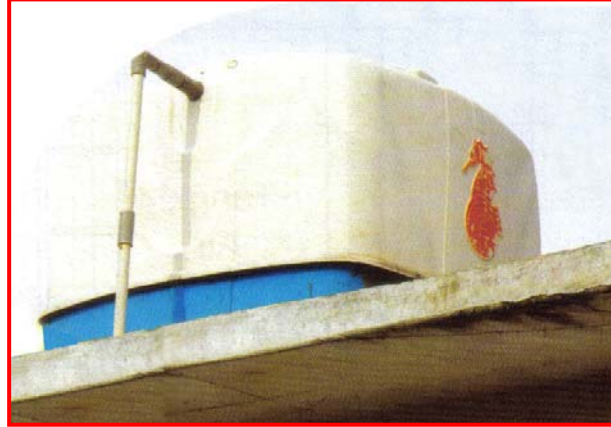
Gambar XV-5, Tangki Air di Atas Dak Beton
